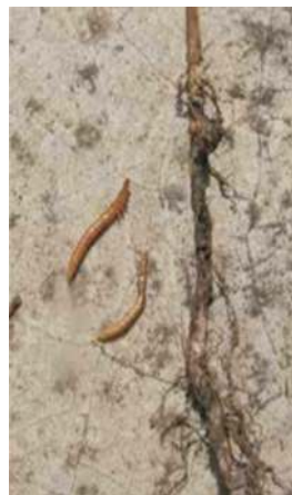
Fig. 61. Plante deteriorate de sârmari
